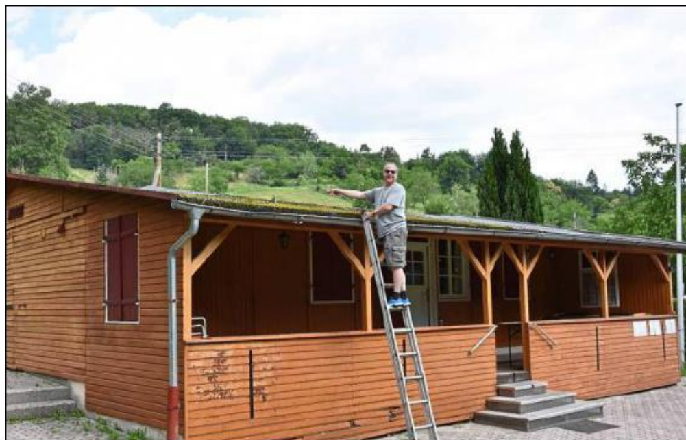
Reparaturbedürftig: Jürgen Maisch, Vorsitzender des TV Gernsbach, zeigt auf das Dach des Vereinsheims „Sonnengarten“, dessen Sanierung ansteht. Foto: Dürr
